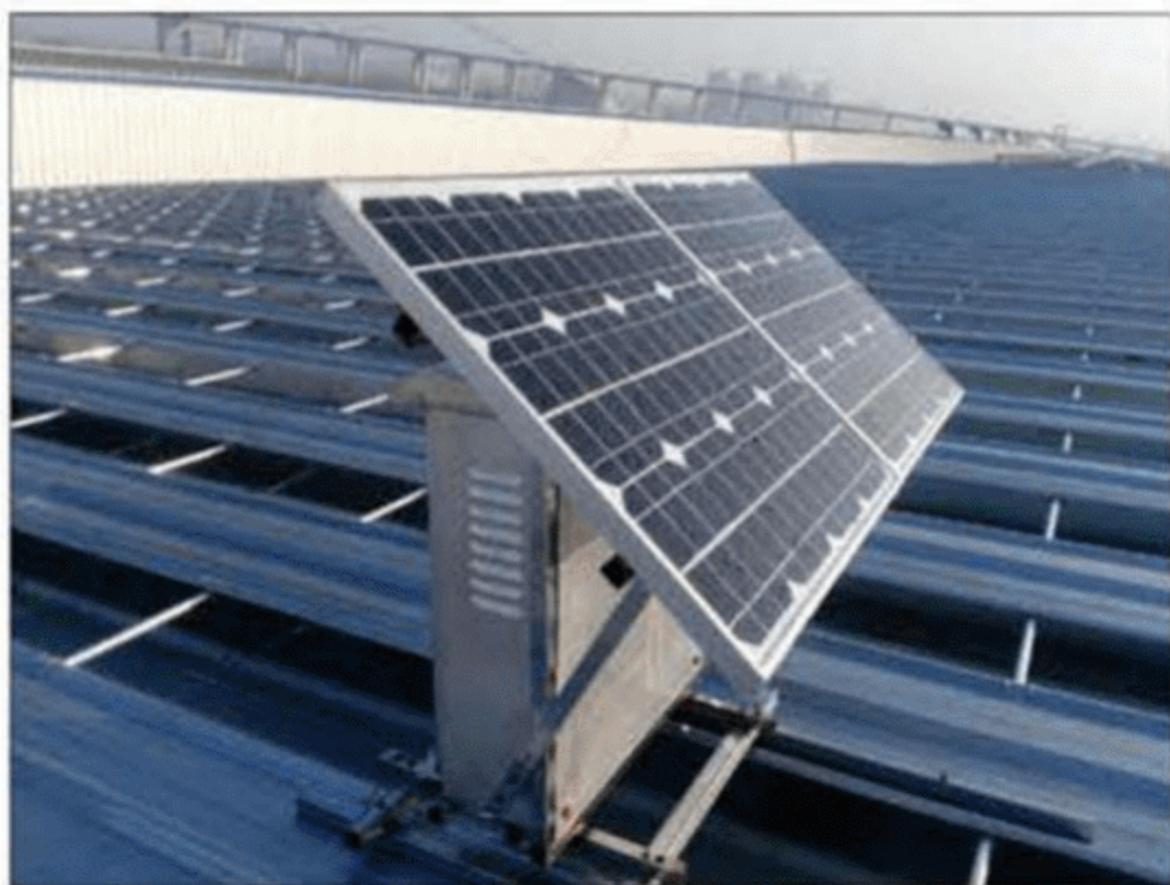
横向通风天窗上设光伏板
